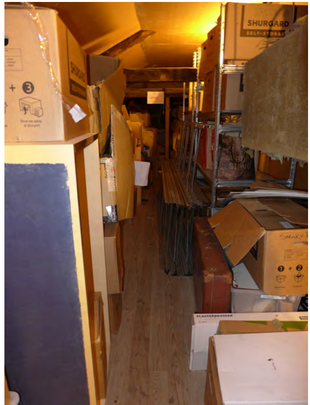
Vinden nyttjas idag som lager och den äldre karaktären har förtagits av att bli den äldre takinbrädningen klätts med moderna skivor.
