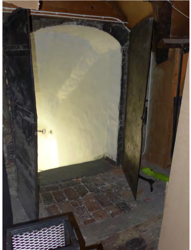
Äldre, sannolikt ursprungliga järnportar mot vinden. Här syns även det ursprungliga brandgolvet av tegel.
